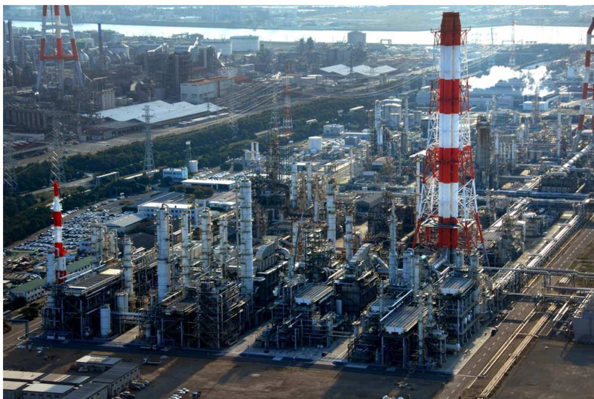
新設した石油化学製品生産設備
